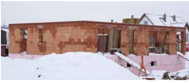
Abb. 1 Winterbaustelle mit starkem Feuchteintritt im Ziegelmauerwerk
